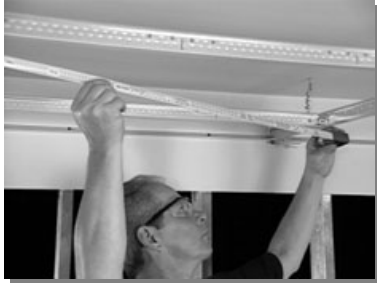
Escuadre la suspensión midiendo a través de la diagonal de la apertura de ésta
