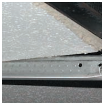
Las tes secundarias sin soporte hacen que se desprendan los paneles.
